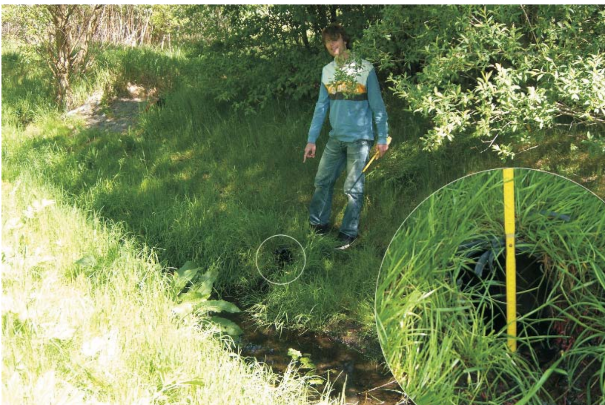
Ablauf Mulden-Rigolen-System im Gewerbegebiet Dahlwitz-Hoppegarten (100 ha versiegelte Fläche!)
